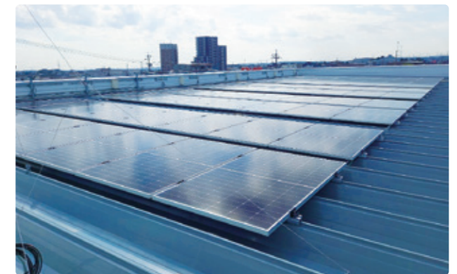
スギ薬局 富士見店の屋上に設置した太陽光パネル
