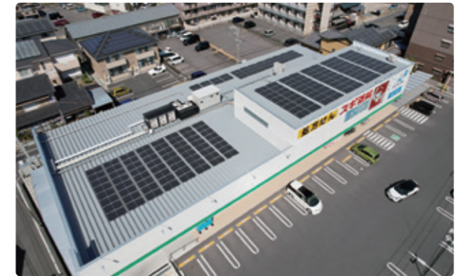
店舗の屋上に設置した太陽光パネル
